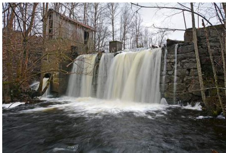
Åmotsdaga – demningen med inntak til rørdledningen.
